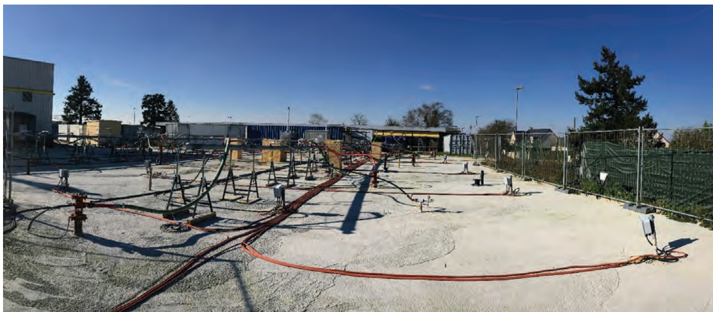
Figure 4 : Vue de l'installation de traitement par ERH.
